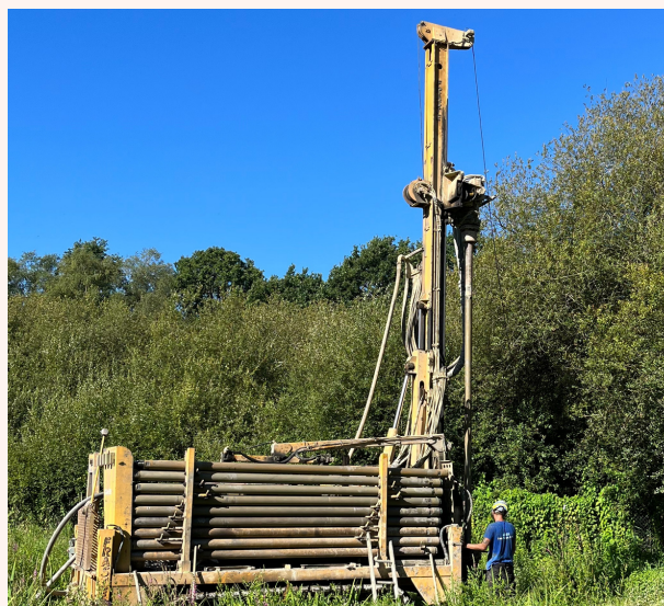
Réalisation du sondage de reconnaissance sur le site de l'Herbage à Dingé
