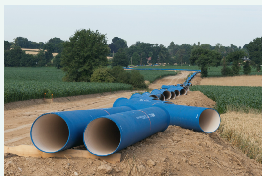
Tuyaux bardés à Vezin
